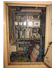
Gambar 10. Sistem Kontrol yang lama
